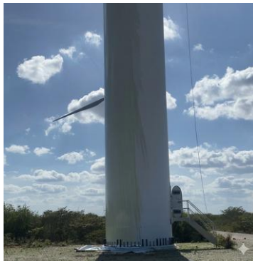
Figura 1 – Vazamento de óleo de uma turbina eólica
