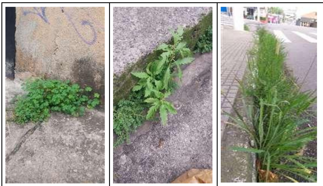
Figura 06 - PANC nascendo nas frestas das calçadas
