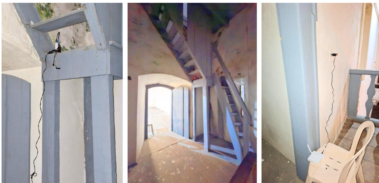
Figura 4: Sensores instalados na Torre da Igreja e roteador. Fonte: Os autores (2026).
