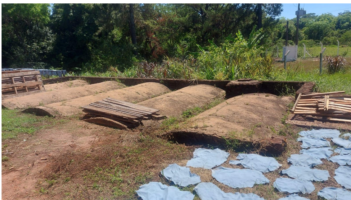
Figura 10: Cinco caixas sépticas. Fonte: Caio Affonso Júnior, 2025.
