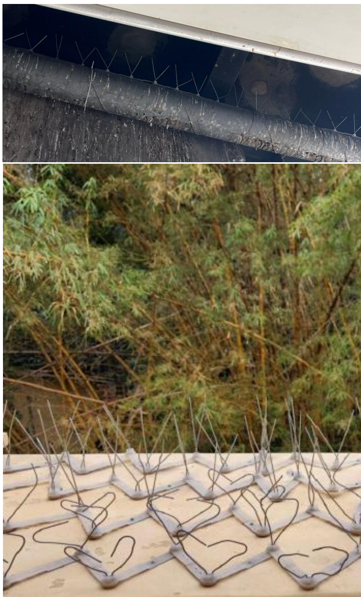
Figura 05: Acima: Detalhe de espinhos instalados na estrutura interna do Centro Cultural São Paulo (CCSP), para afastar pombos. Abaixo: Espinhos instalados no Museu Ipiranga, com destaque para a intervenção realizada por visitantes, que entortaram uma parte dos metais, retirando seu potencial hostil e transformando em um formato de corações com o próprio material. Foto: Tatiana Gaspar, 2024.
