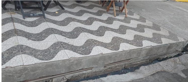
Figura 4: Calçada sem acessibilidade na Feira do Mangueirão
