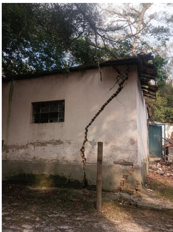
Figura 2: Rachadura na edificação histórica do parque
