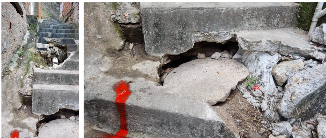
Escada quebrada (com cano que passa por dentro); fossa destruída (em um dos degraus da escada) – fotos minhas.
