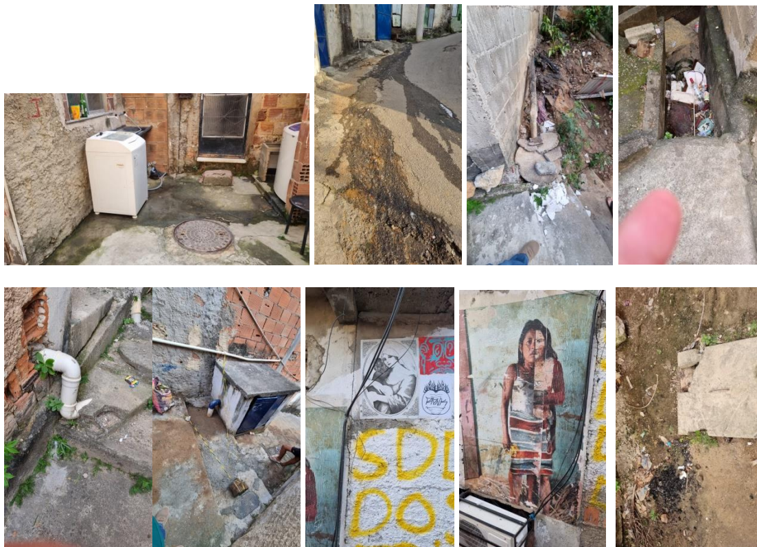
Caixa de esgoto transbordando entre as máquinas de lavar roupa; água jorrando na rua; encanamento exposto; detritos entre casas; encanamento improvisado; manutenção falha ao redor de uma das bombas d'água; menino Jesus negro?; grafite; tampa de fossa quebrada – fotos minhas
