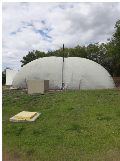
Figura 4: Sistema de biogás da ETE: gasômetro (cúpula) com malha inflada.
