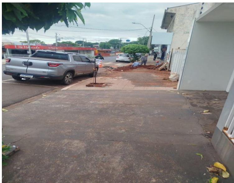
Figura 10 - Obra na calçada sem sinalização e isolamento.
