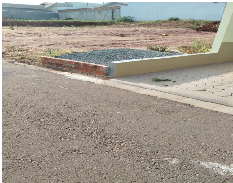
Figura 17 - Desnível/elevação na calçada.
