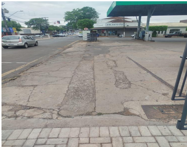
Figura 11 - Trecho de calçada com revestimento em condições incompatíveis com a normativa.
