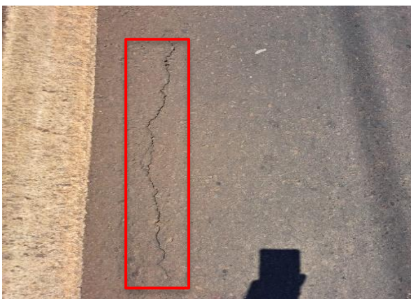
Figura 38 – Trinca longitudinal longa
