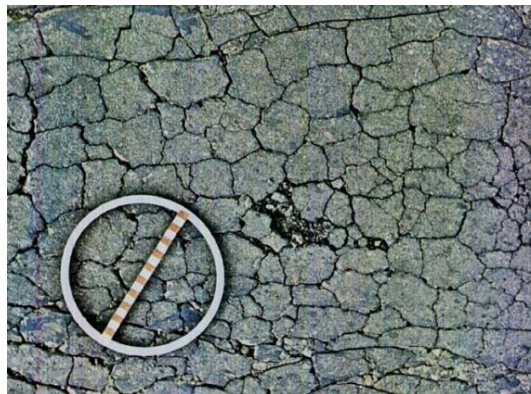
Figura 4 – Trinca tipo couro de jacaré
