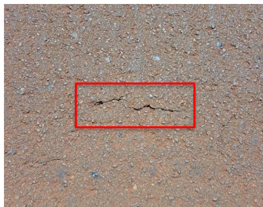
Figura 31 – Trinca transversal curta
