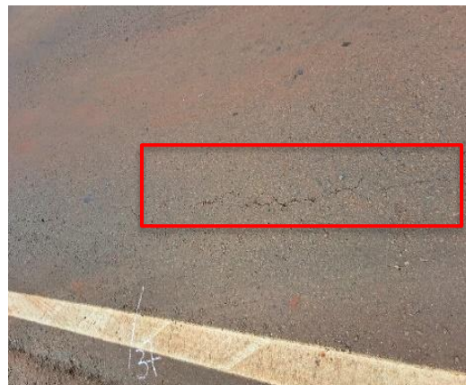
Figura 39 – Trinca longitudinal longa
