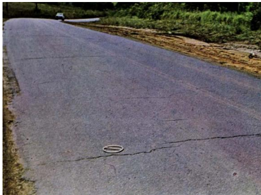
Figura 2 – Trinca isolada transversal
