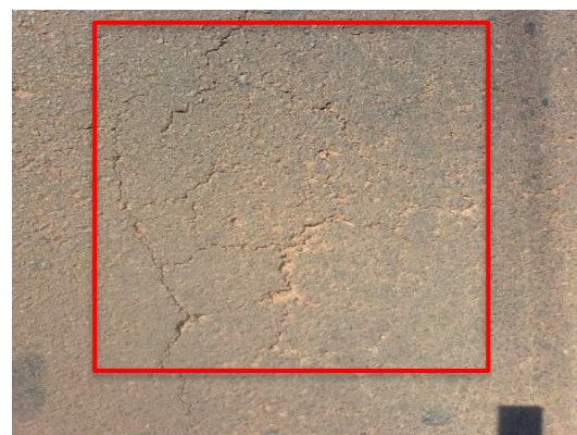
Figura 25 – Trinca em bloco com erosão
