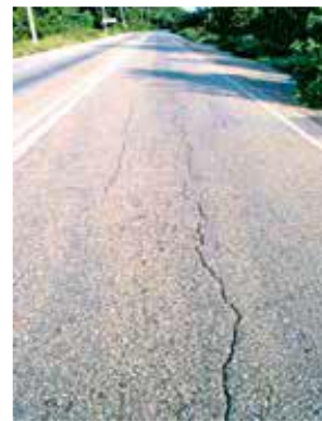
Figura 3 – Trinca longitudinal longa
