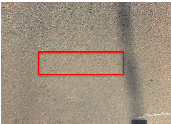
Figura 30 – Trinca transversal curta
