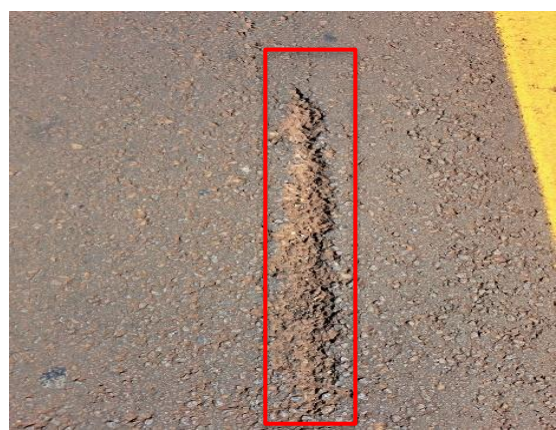
Figura 21 – Trinca longitudinal com erosão
