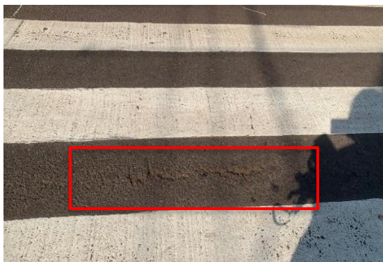
Figura 16 – Trinca longitudinal com erosão
