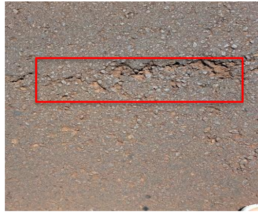
Figura 33 – Trinca transversal com erosão
