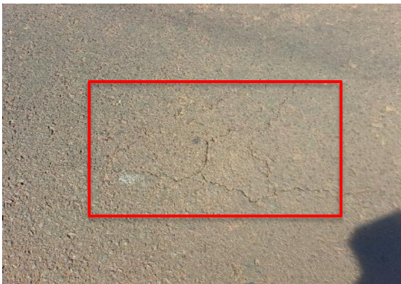
Figura 24 – Trinca em bloco
