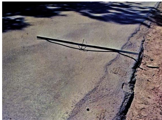
Figura 5 – Afundamento da trilha de rodagem.
