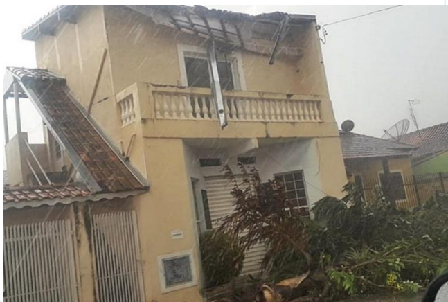
Figura 4 - Danos provocados por chuva de granizo.
