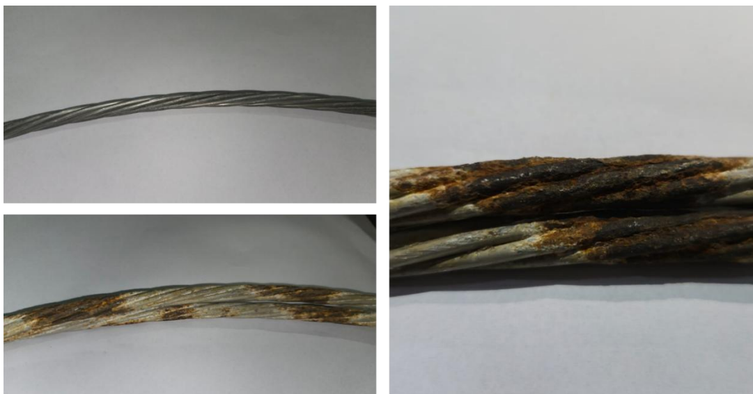
Figura 1. Imagens de cordoalhas no estado novo e oxidado (utilizadas em serviço).
