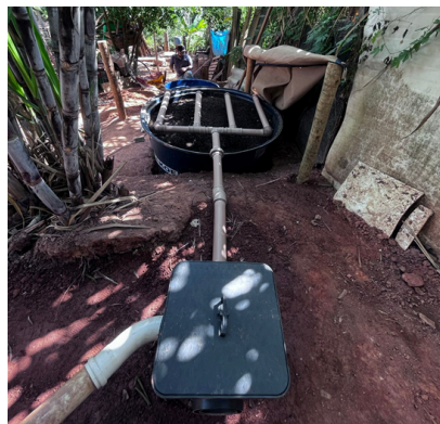
Figura 3 – Sistema de tratamento de água cinza construído (Autores, 2025)
