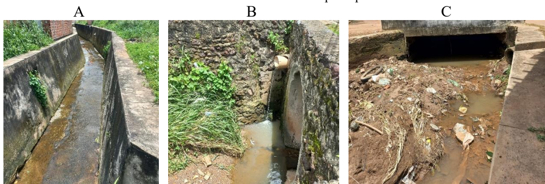
Figura 6: A- Área canalizada, B- Descarte de esgoto doméstico no canal, C- Local de descarte e acúmulo de lixo e sedimento no canal principal.
