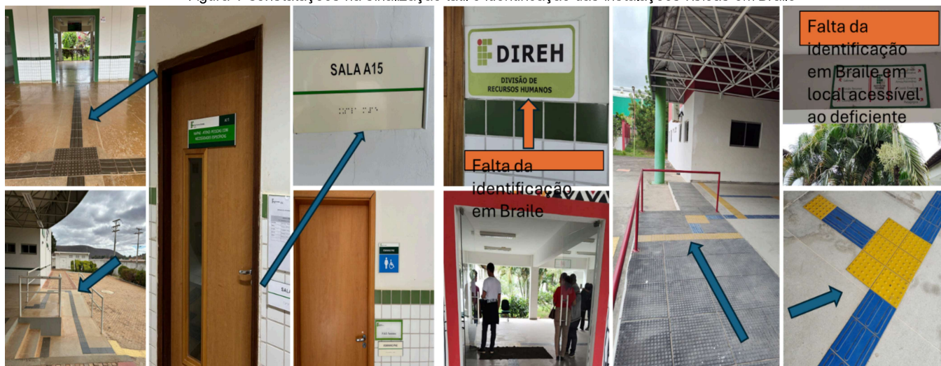
Figura 1 Constatações na sinalização tátil e identificação das instalações físicas em Braile
