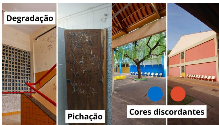
Figura 1: Degradação, pichação e cores discordantes
