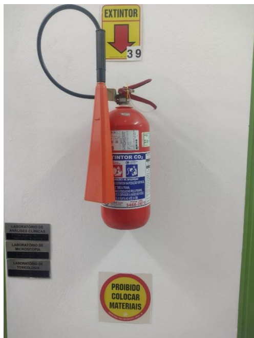
Figura 2 - Extintor de incêndio presente na entrada dos laboratórios
