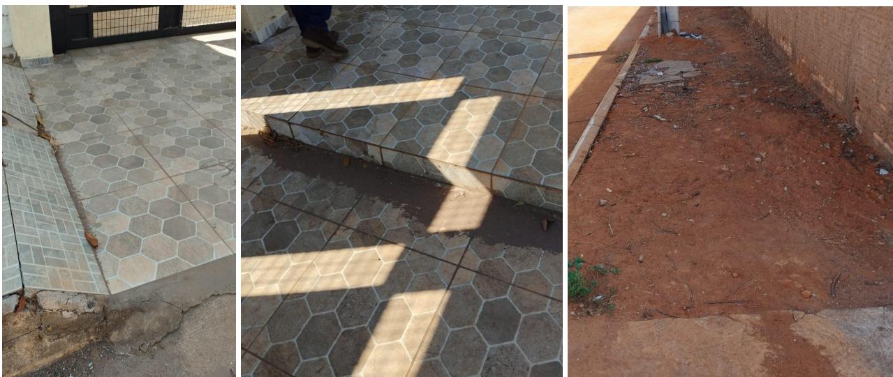
(A) Inclinação inadequada
