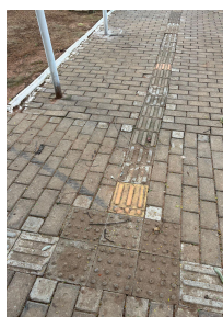
Figura 2: Falta de manutenção
