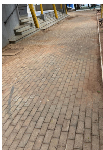
Figura 1: Ausência de piso tátil
