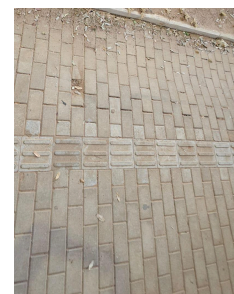
Figura 3: Buracos na calçada
