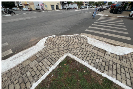
Figura 4: Rampas com inclinação inadequadas
