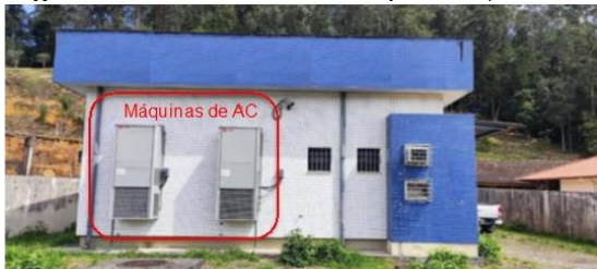
Figura 3 – Local de instalação AC, área externa
