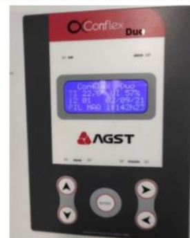
Figura 4 – Controlador das máquinas de AC
