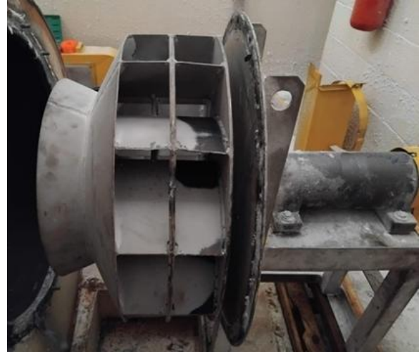
Figura 3 - Em destaque as pás do exaustor rotativo
