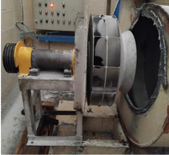
Figura 2 - Exaustor de filtro rotativo danificado
