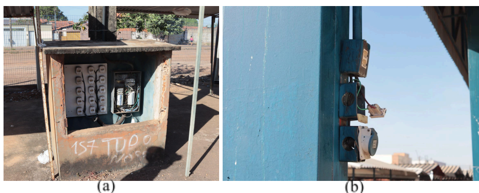
Figura 3 – Instalação elétrica: (a) danificada; (b) sem proteção
