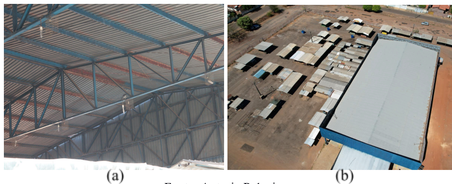
Figura 1 – Corrosão na estrutura do telhado: (a) Vista inferior; (b) Vista superior
