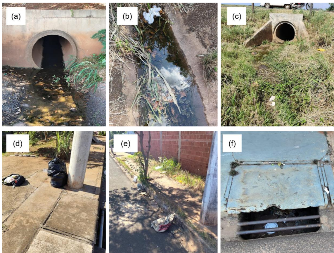
Figura 2: Possíveis pontos a serem estudados na área de estudo: (a), (b), (c) sistema de drenagem e água parada; (d) ponto de armazenamento de resíduos; (e) descarte de resíduos nas ruas; (f) bocas de lobo e presença de resíduos
