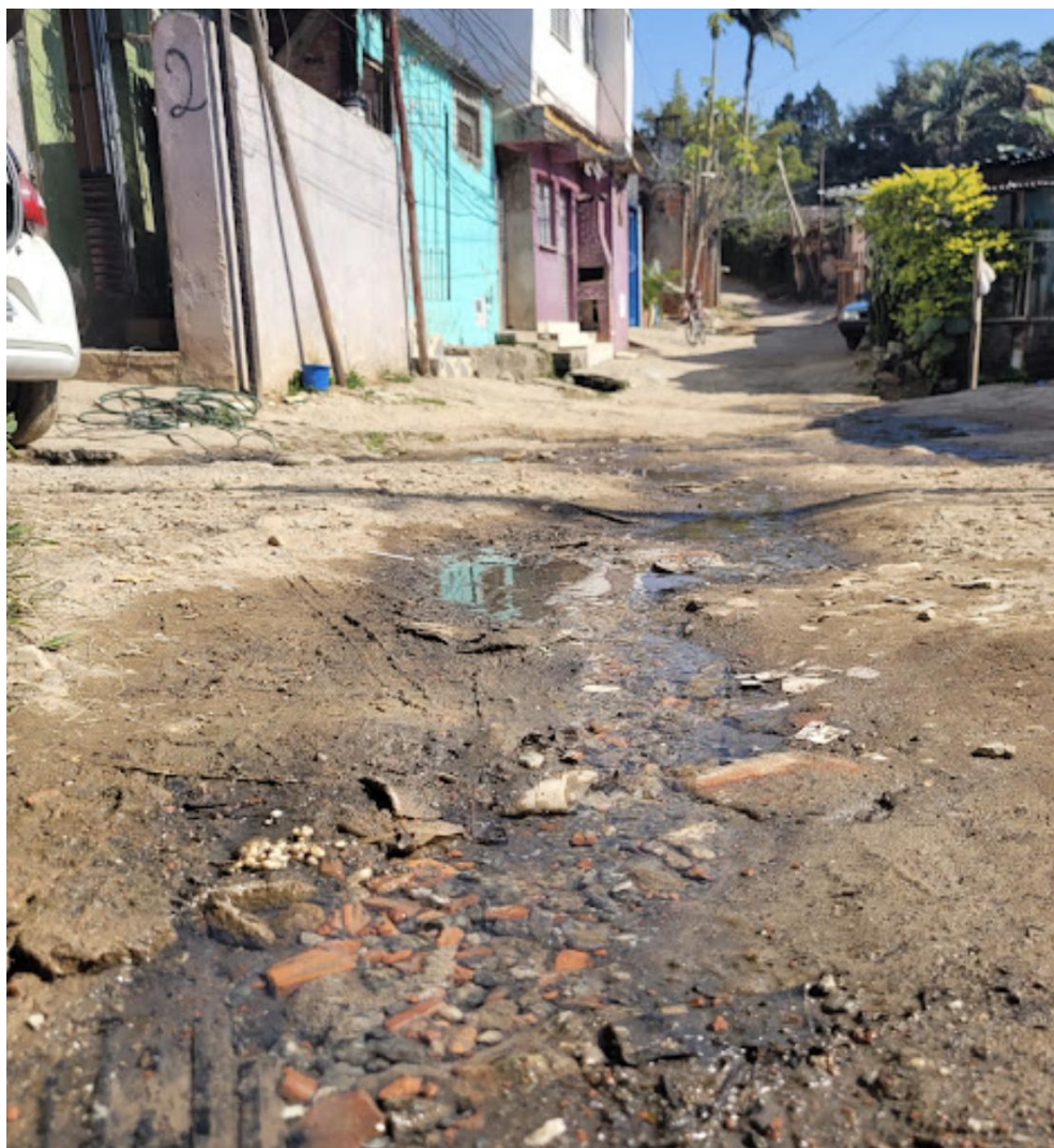
Figura 2. Foto de uma viela da comunidade com vazamento de esgoto
