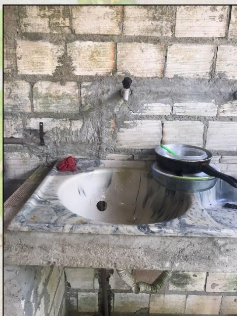
Figura 2 - Pia instalada em ambiente com estrutura precária e ausência de revestimento.
