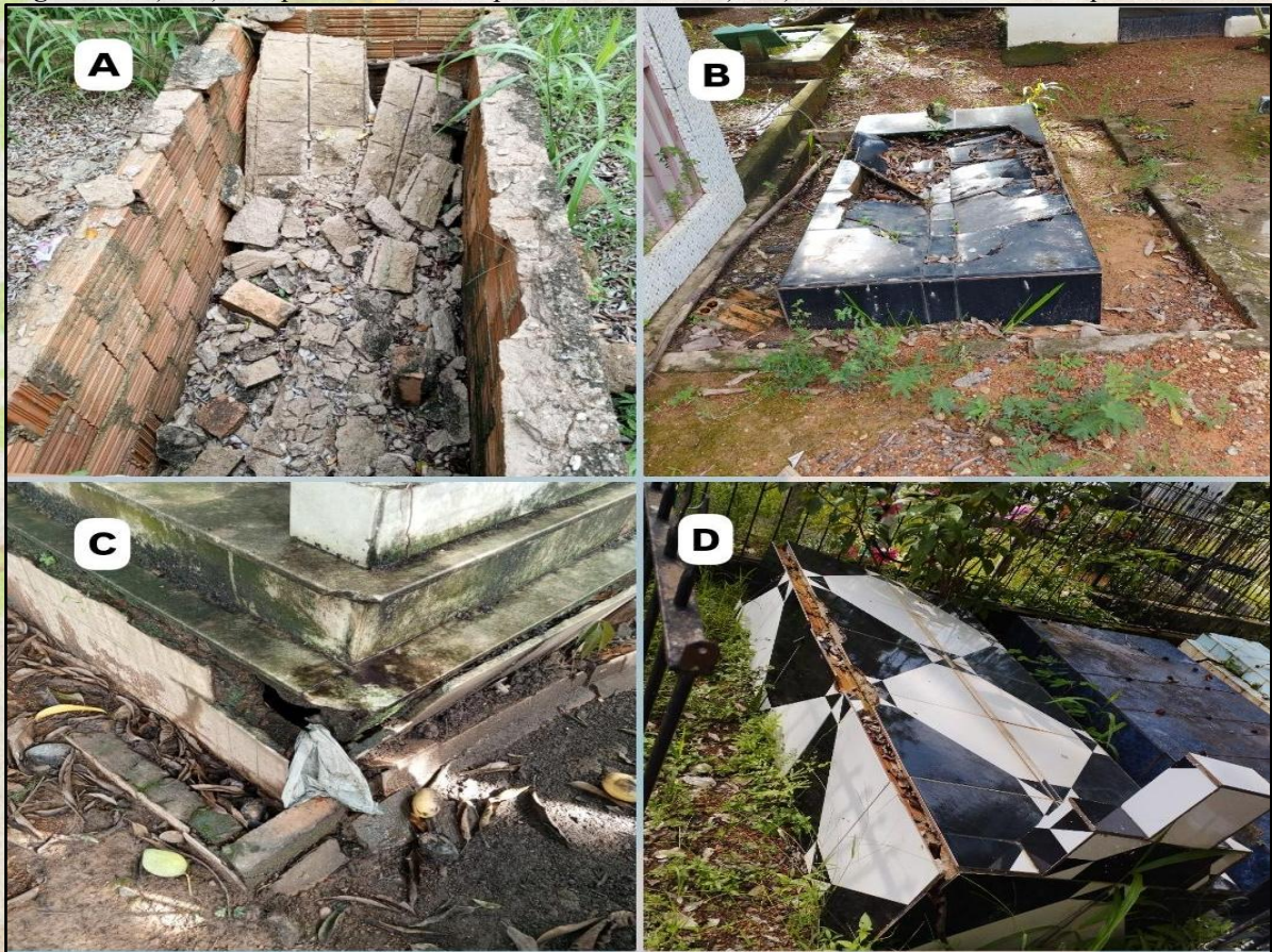
Figura 1 - A) e B) Colapso da estrutura superior de túmulos. C) e D) Túmulos com danos nas quinas e bordas.
