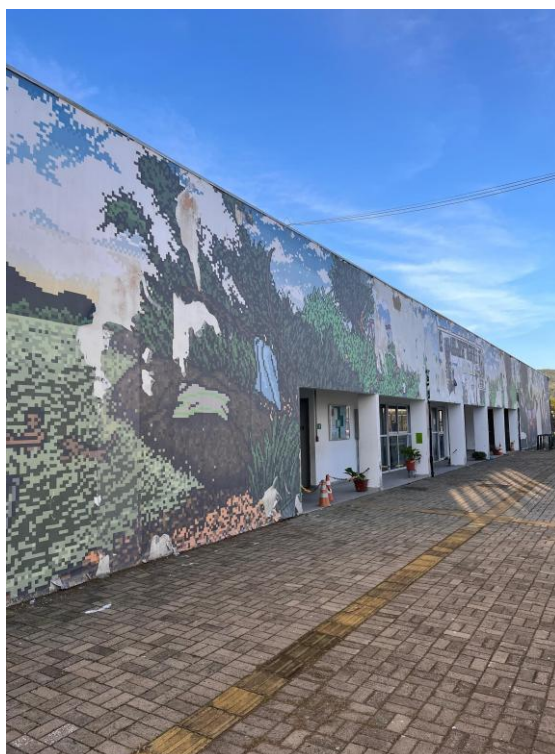
Imagem 3. Instalação na Estação Cidadania Restinga, mostrando as más condições da obra Passe Livre , do artista Felipe Veek.
