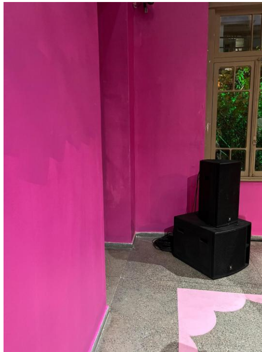
Imagem 4. Paredes mal finalizadas na obra Bússola , da artista Nicole L'Huiller, instalada na Casa de Cultura Mario Quintana, um dos espaços de maior visibilidade da mostra.
