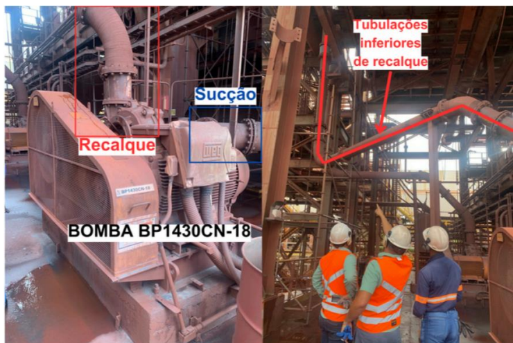
Figura 1 – Bomba BP1430CN-18 e tubulações inferiores de recalque
