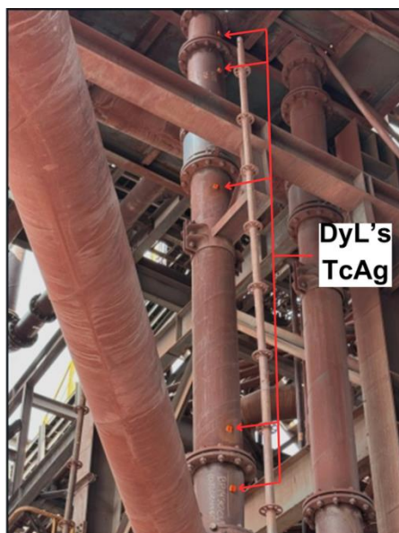
Figura 2 – Sensores DynaLoggers do modelo TcAg instalados em trechos de tubulação de recalque
