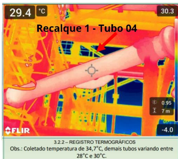
Figura 6 – Imagem de registro termográfico coletado no Recalque 1 – Tubo 4 e anexado ao relatório de preditiva realizado pelo time da Vale Itabira.
