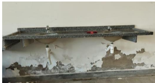
Figura 25. Desplacamento de revestimento em cozinha.
