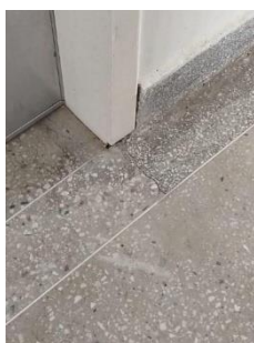
Figura 15. Fissura em piso.
