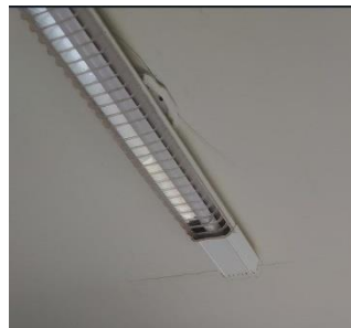
Figura 17. Fissura em forro de gesso.
