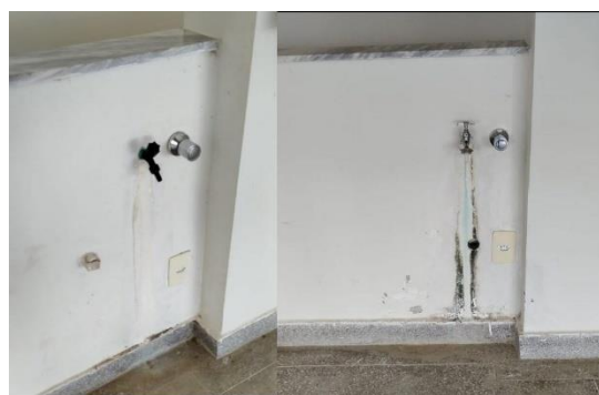
Figura 29. Mancha de mofo em vazamento de torneira.
