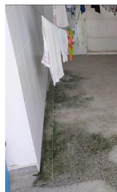
Figura 21. Mancha de mofo em piso área molhada.
