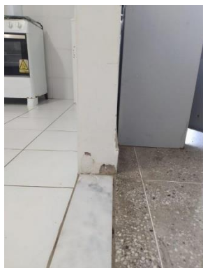
Figura 24. Desplacamento de revestimento.
