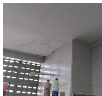
Figura 22. Infiltração em banheiro.
