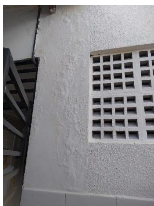
Figura 27. Bolhas em revestimento de paredes.
