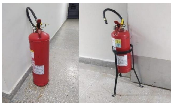
Figura 30. Extintores instalados de maneira inadequada.
