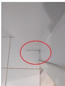
Figura 16. Fissura em piso área molhada.
