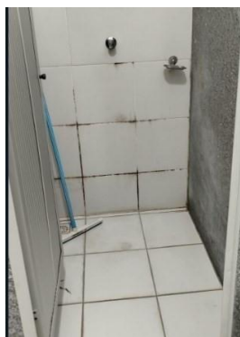
Figura 20. Mancha de mofo em parede área molhada.
