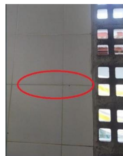
Figura 14. Fissura em revestimento cerâmico.
