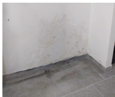
Figura 18. Mancha de umidade em parede.
