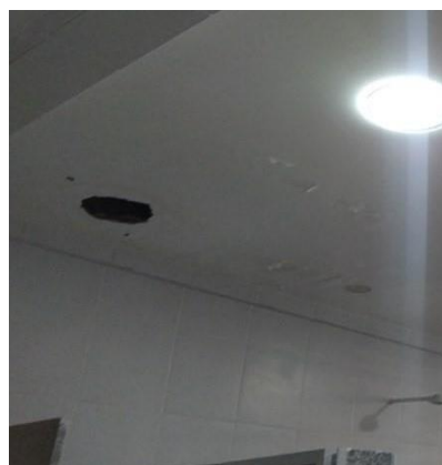
Figura 26. Desplacamento de forro de gesso.
