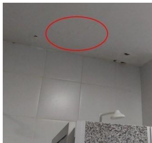
Figura 28. Bolhas em revestimento de teto.
