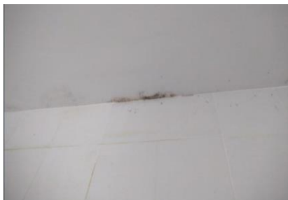
Figura 23. Mofo em teto.
