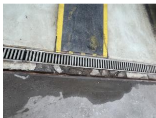
Figura 3 – Infiltração próxima à canaleta de escoamento.
