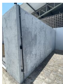
Figura 4 – Trincas e umidade em parede externa.
