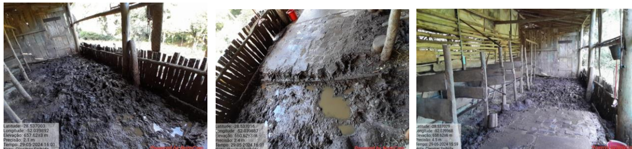
Figura 1: Sala de ordenha, piso do galpão e canzil após os alagamentos
