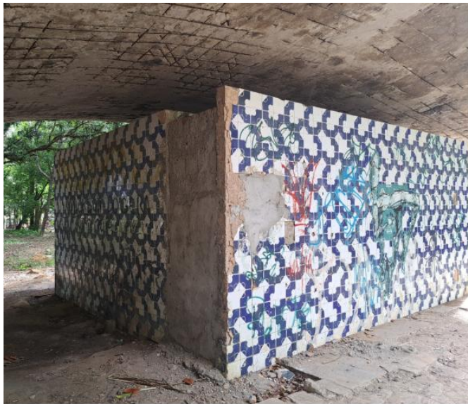
DANOS EM AZULEJOS DAS LANCHONETES DO PARQUE. FONTE: AFONSO, 2024.
