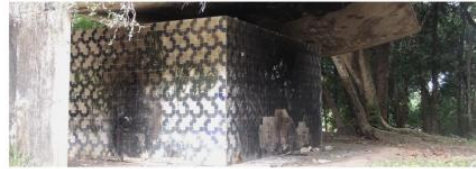
DANOS EM AZULEJOS DAS LANCHONETES DO PARQUE. FONTE: AFONSO, 2024.
