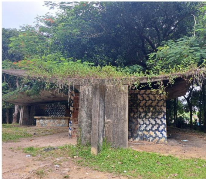
DANOS NAS COBERTURAS E LAJES DAS LANCHONETES DO PARQUE. FONTE: AFONSO, 2024.
