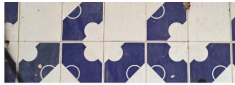
DANOS EM AZULEJOS DAS LANCHONETES DO PARQUE. FONTE: AFONSO, 2024.
