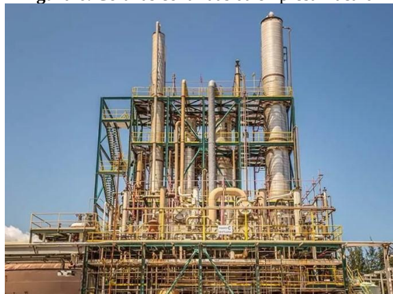
Figura 6. Colunas contínuas da empresa Bacardí
