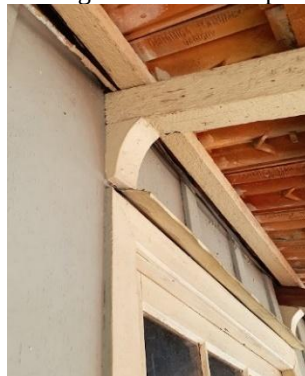
Figura 5 - Fotografia de 2024 - Pingadeira acima da porta, na fachada frontal da casa
